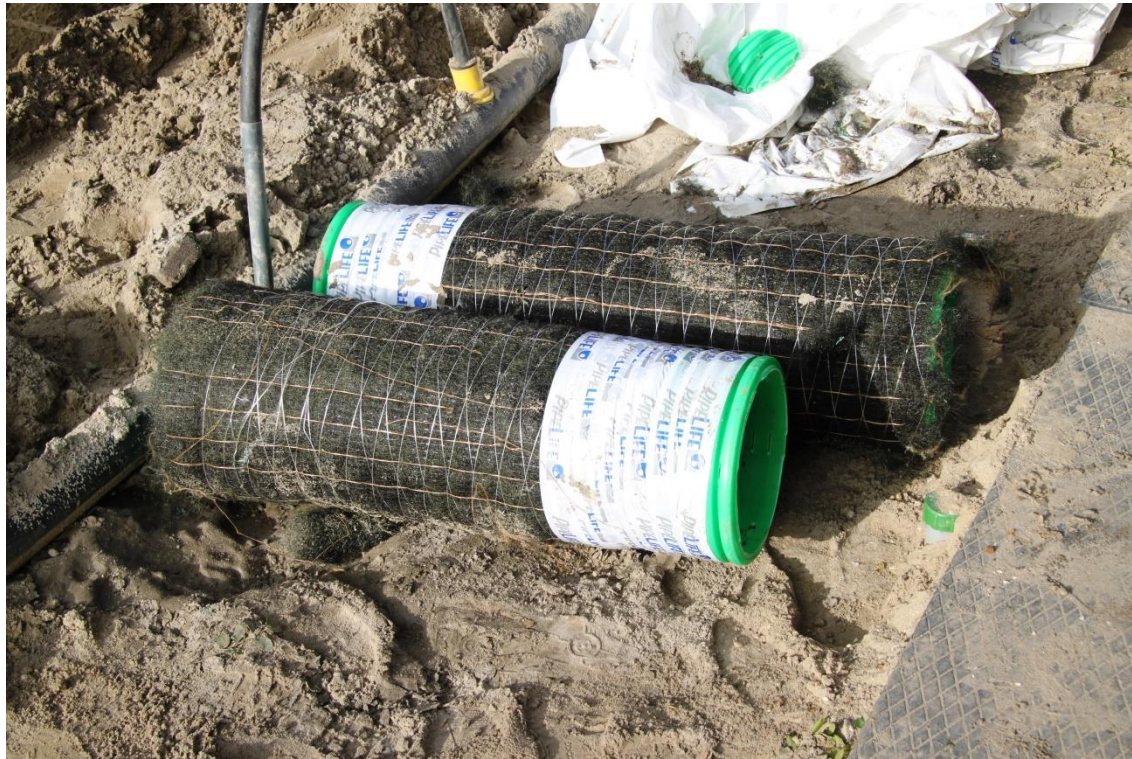
infiltratie transport riool
